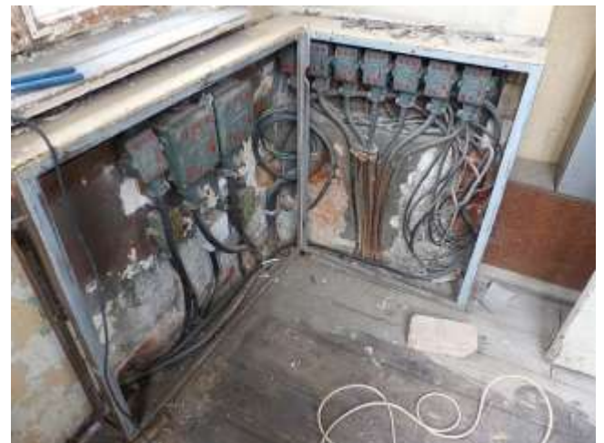
Die ehemalige Verkabelung soll möglichst in dieser Form erhalten und sichtbar bleiben. (Foto 17: 2026)
