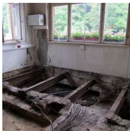
Kurz darauf, in den Jahren 2014 war der Holzfußboden im Erdgeschoss vom Schwamm zerstört und alle bisherigen Sanierungsarbeiten waren damit weitgehend wieder zunichte gemacht. Daraufhin ließ die Stadt Gransee neue Dielen legen (Foto 11).
